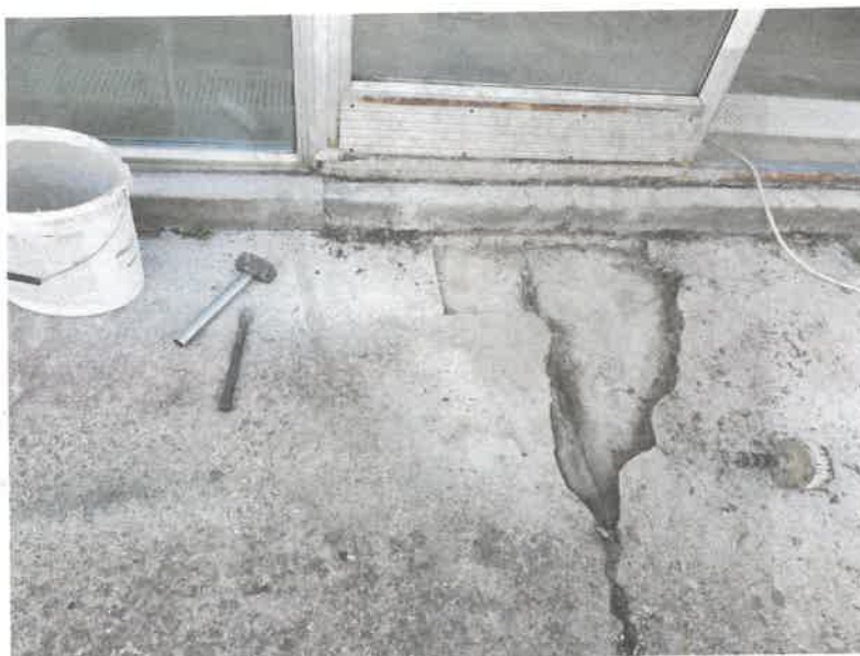
Obr. 7.5 – Balkón – sonda do podlahy a poruchy
