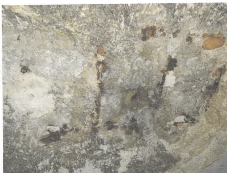
Obr. 7.6 – Detail stropu v suterénu v místě poruchy v SZ části
