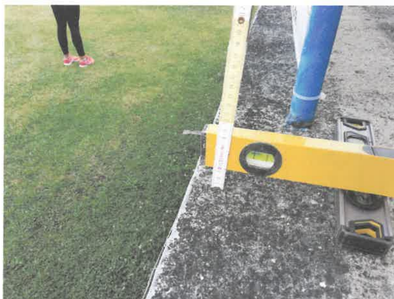
Obr. 7.2 – Balkón, deformace cca 40 mm na 1 m
