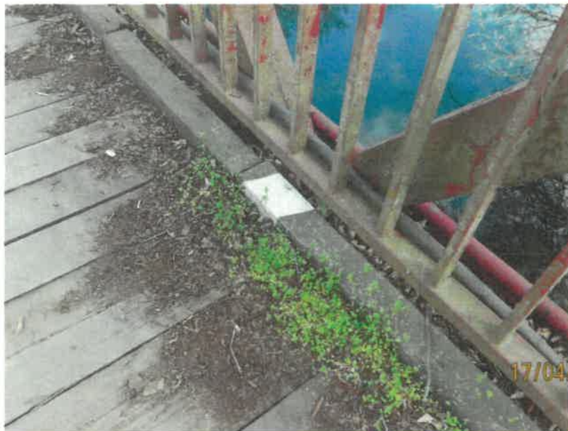
Poškozený prvek mostovky- detail.
