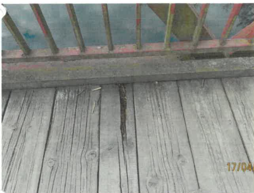
Hnilobou poškozené prvky mostovky.
