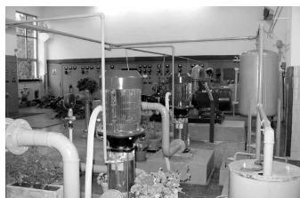
Úprava vody Pracejovice.
