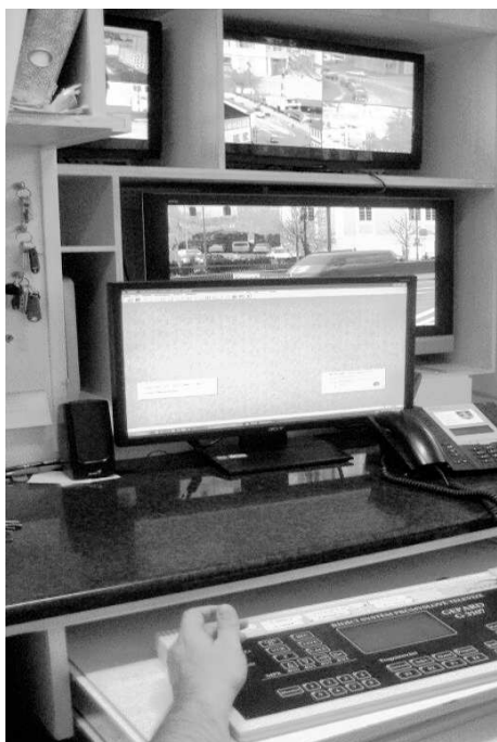
Centrum kamerového systému.
